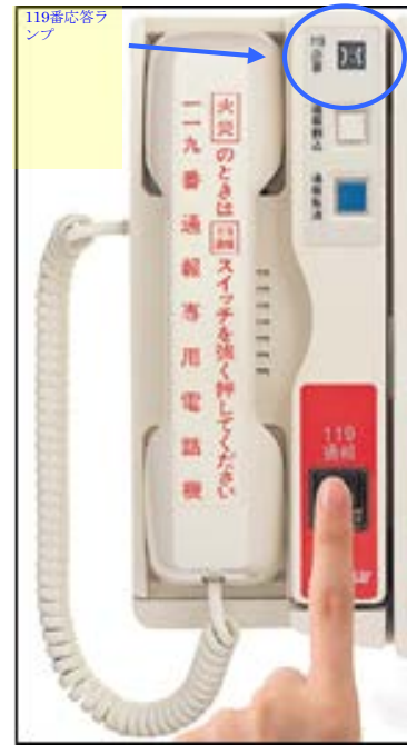
火災通報装置
