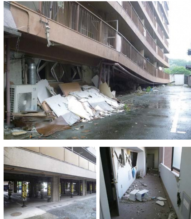
【写真:被害の様子】
