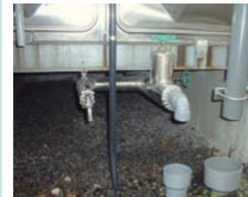
・既存の貯水槽に多く見られる配管工事例で工事も簡単。
