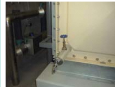
・新しく設置した貯水槽によく見られる。
