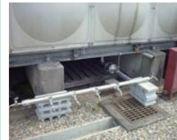
・災害用給水じゃ口は脱着方式で地震災害時のみ装着。
