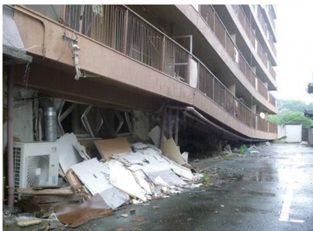
【写真：被害の様子】
