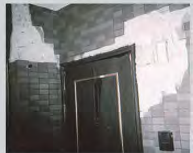
被害を受けたマンション (福岡県西方沖地震)
