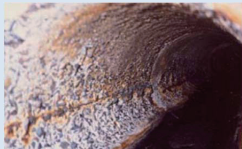
写真 老朽化した下水道管内の状況
