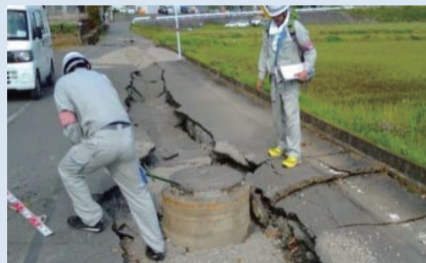
写真 平成28年（2016年）熊本地震の被害（益城町）
