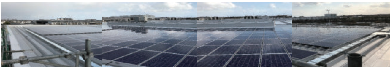
太陽光パネル
