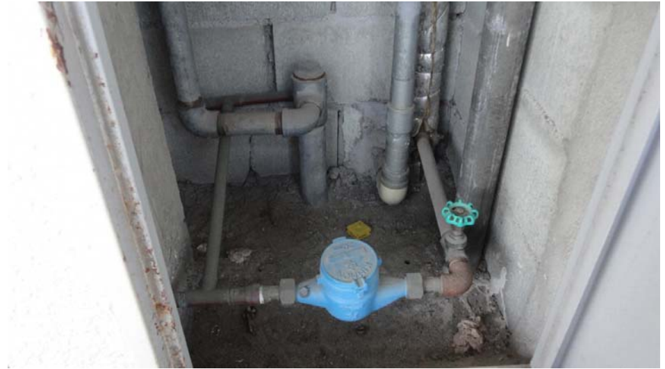
メーターBOX内
