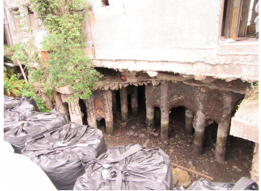
杭が露出している
