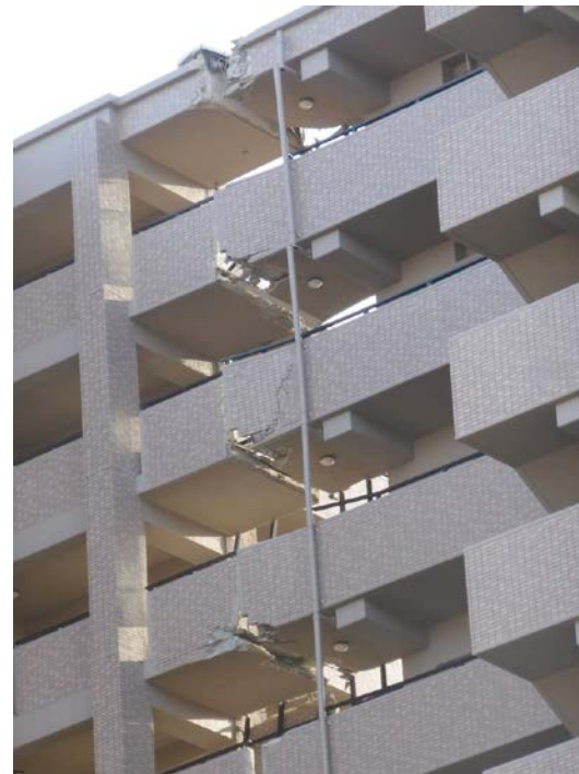
エキスパンションジョイント部の破壊
