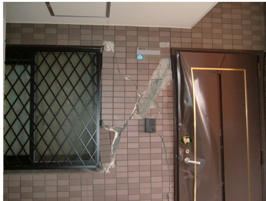
非耐震壁の被害 (ドアが開かない)
