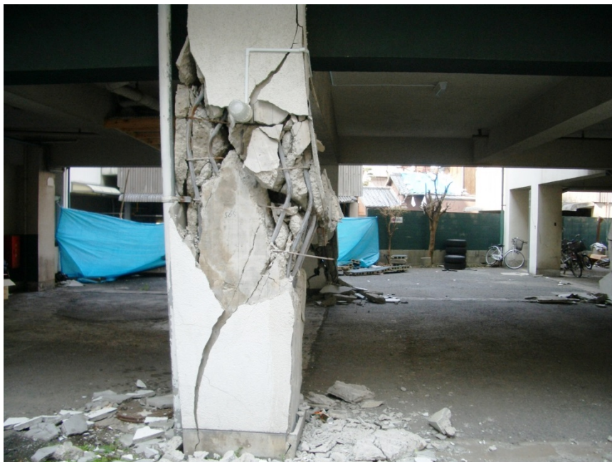
マンション1階柱の被害 (ピロティ柱)
