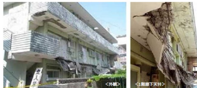
マンションの2階廊下部分が崩落した事例 【国土交通省資料より】
