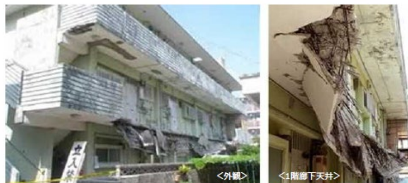
<マンションの2階廊下部分が崩落した事例〔国交省資料より〕>
