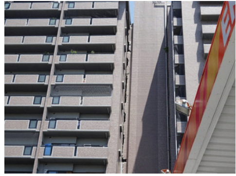
エキスパンションジョイント部崩壊
