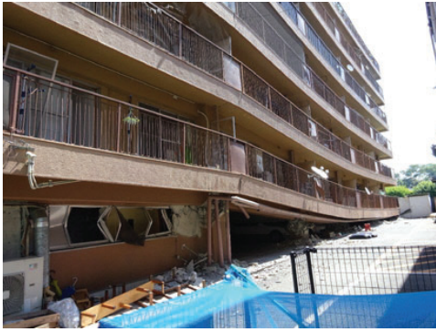
熊本市西区 RC造9階建41戸 築42年 ピロティ部崩壊
