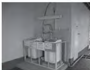
4 仮設洗濯機を設置した事例 夜8時になるとタイマーで電 源が切れる。使用上のルール も書いてある
