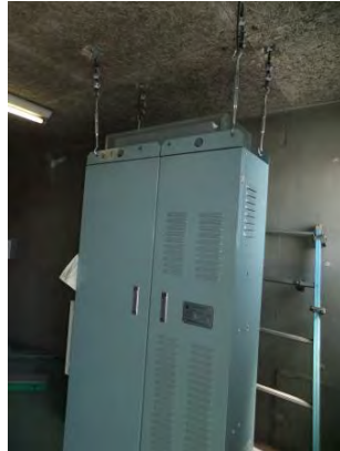
制御盤の振止め
