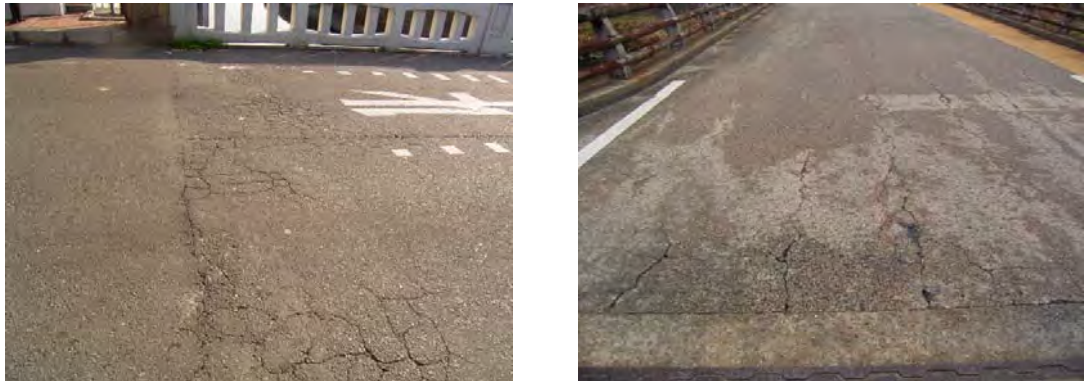
写真 7-1 舗装ひび割れの変状事例
