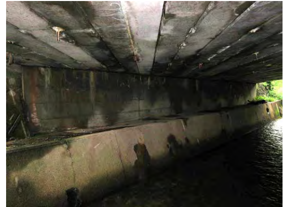
床版間詰部(橋面からの漏水)、橋台の桁受け部
