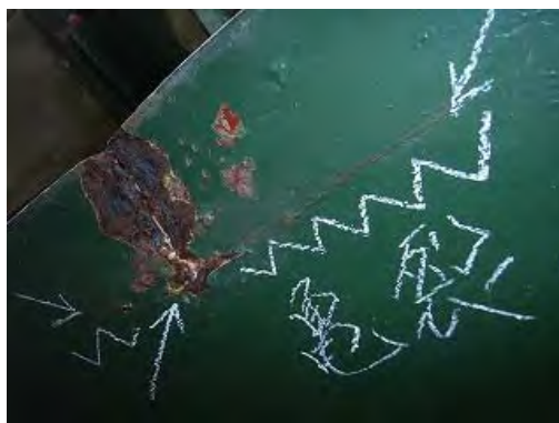
写真 4-2 亀裂による劣化の事例
