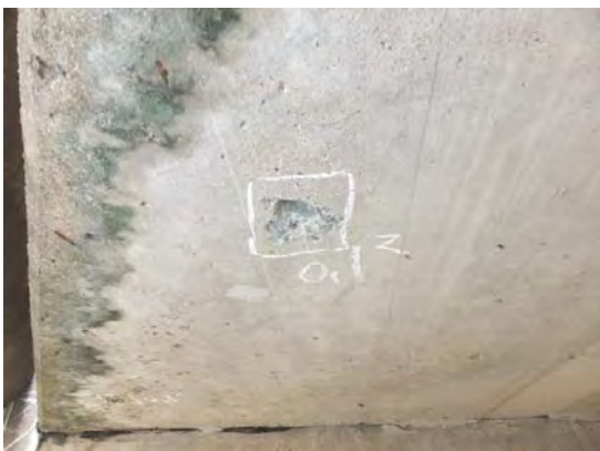
床版端部(水の回り込み)
