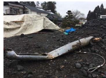
断層部で被災した既設下水道管
