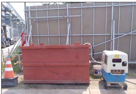
写真②-6 工事用車両のタイヤ洗浄設備
