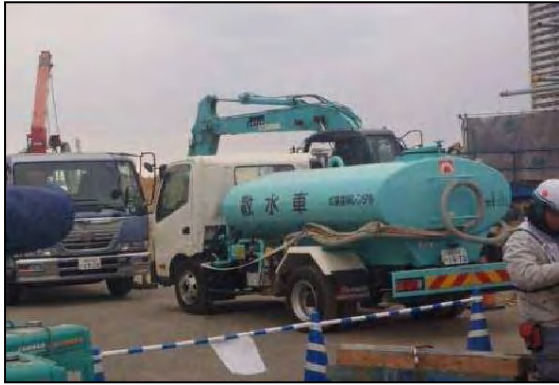
写真③-1 施工ヤードへの散水設備
