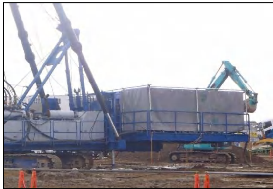
写真③-3 発電機の防音シート
