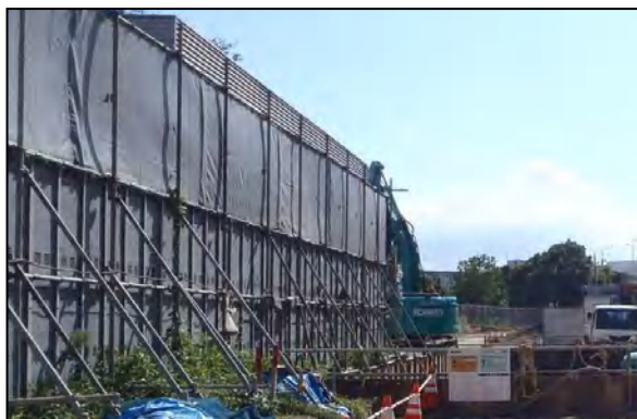
写真①-3 防音パネル等の遮音対策
