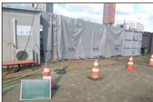
写真①- 3 防音シート等の遮音対策
