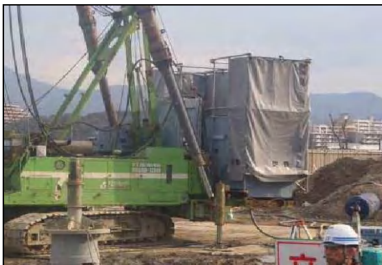
写真②-3 発電機の防音シート
