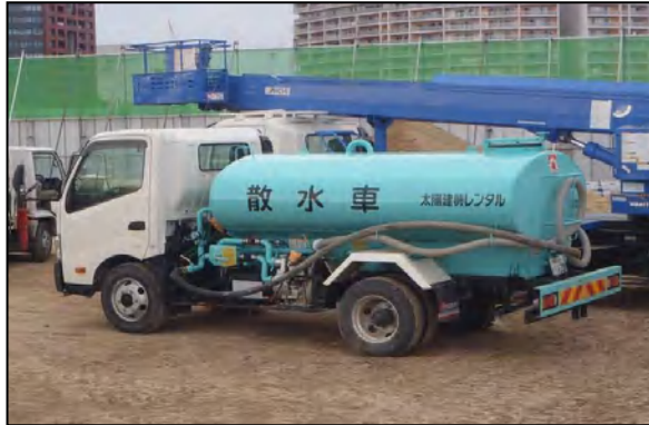
写真③-1 施工ヤードへの散水設備
