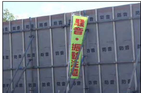
写真①-4 防音パネル等の遮音対策
