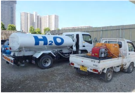
写真②-1 施工ヤードの散水設備
