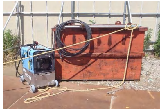
写真②-6 工事用車両のタイヤ洗浄設備
