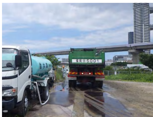
写真③-6 工事車両のタイヤ洗浄設備
