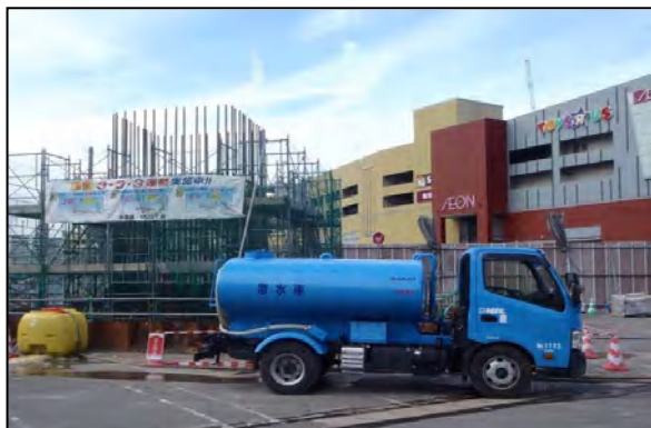
写真①-1 施工ヤードへの散水設備
