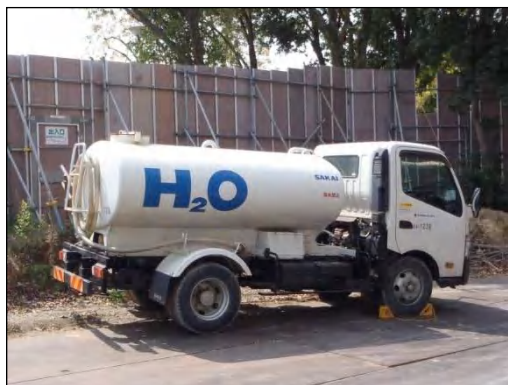
写真①-1 施工ヤードへの散水設備
