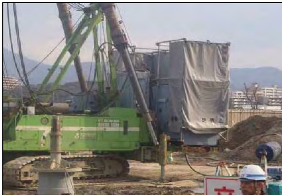
写真②-3 発電機の防音シート
