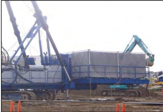
写真③-3 発電機の防音シート
