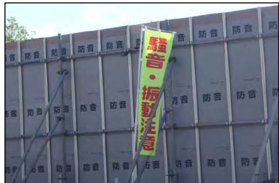
写真①-4 防音パネル等の遮音対策
