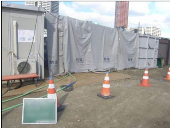
写真①-3 防音パネル等の遮音対策
