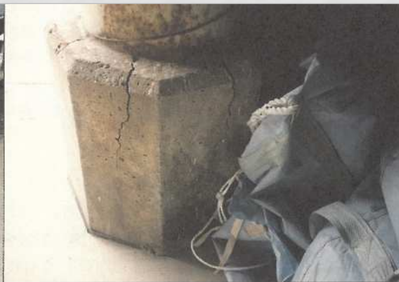
広告塔脚部コンクリート基礎のひび割れ
