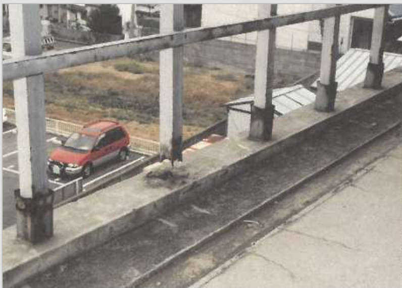
屋上手すりの支持部腐食
