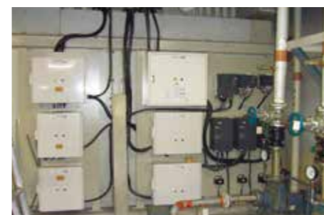
空調機インバーター
