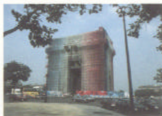
工事中の養生ネットと仮囲いのデザインを国際コンペに附し都市景観に深い配慮をするパリの凱旋門。(1988年)
