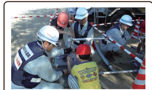
<応急給水栓から給水を受けている様子>
