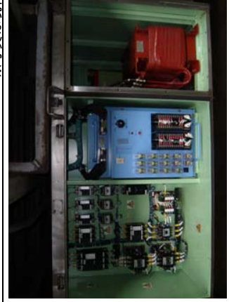
空調制御装置
