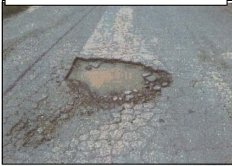
(路面破損状況)
