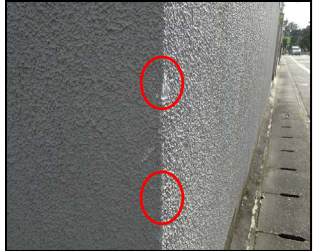
②破損状況
