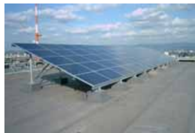
▲ 太陽光発電システム
