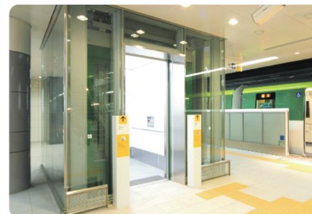
エレベーター
