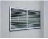
夜間換気窓(廊下側)
