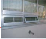
夜間換気窓(教室側)
