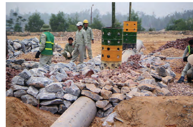
鹿ドラム缶を使ったガス抜き管の施工(ベトナム国ハノイ市ナムソン埋立場)(2005年)
