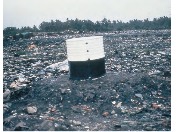
廃ドラム缶を使ったガス抜き設備
