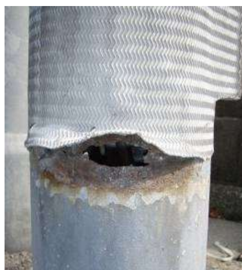
写真 4-2 損傷例：支柱上部の穴あき 対策区分Ⅳ
