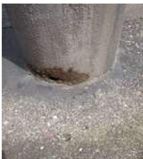
写真 4-1 損傷例：支柱地際部の穴あき 対策区分Ⅳ
