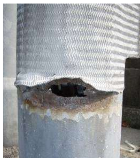
写真 6-2 損傷例：支柱上部の穴あき 対策区分Ⅳ
