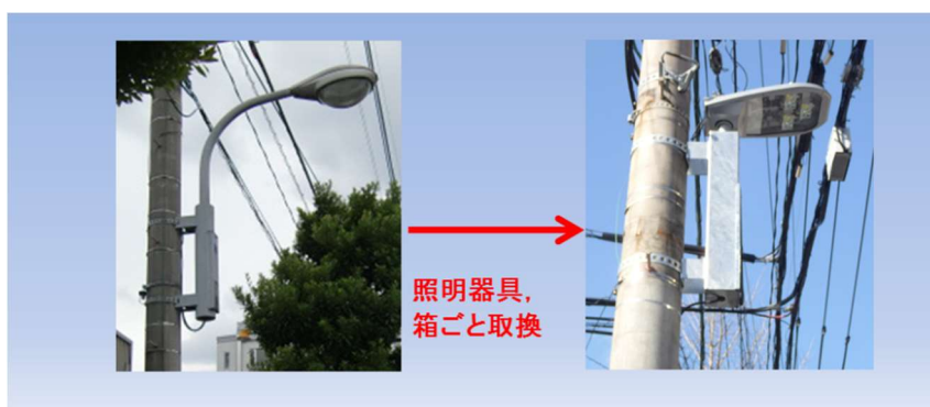
図3. 共架式照明のLED化
