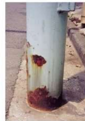
▲地際部 穴の深により錆びた状態
