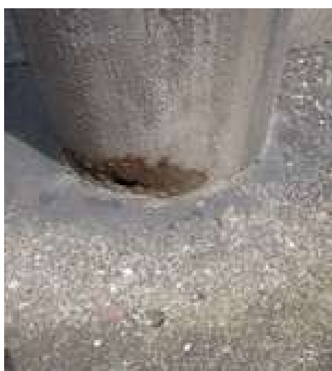
写真 6-1 損傷例：支柱地際部の穴あき 対策区分Ⅳ
