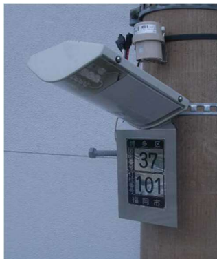
図4. 生活道路の防犯灯(直営灯)
