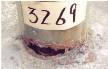
▲地際部が錆び、孔が開いた状態
