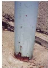
▲地際部 穴の深により錆びた状態
