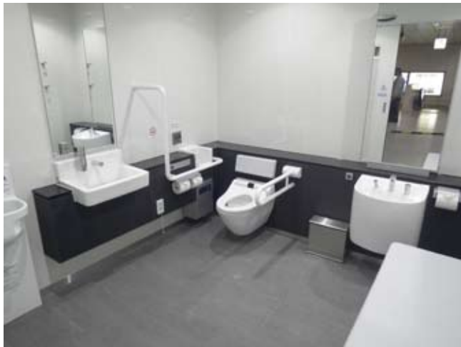
みんなのトイレ/面台の高さを揃えてすっきりとした空間とし、温水の出るオストメイト(*)対応設備と多目的シートを設置しています。
