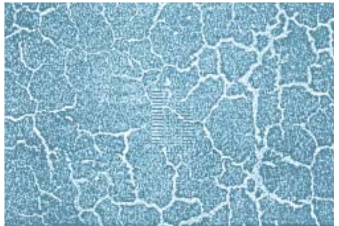
写真2 露出部分のコンクリート表面…かなり劣化している
