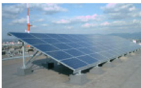
図 福岡市本庁舎屋上の太陽光発電システム（出力 10kW）
