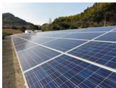
図 2-45 西部中田埋立場に設置した 大原メガソーラー発電所
