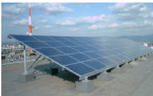
図 2-48 福岡市本庁舎屋上の太陽光発電システム (出力 10kW)
