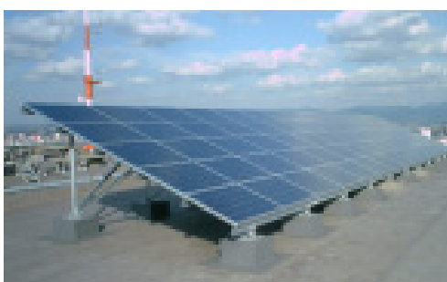
図 2-47 福岡市本庁舎屋上の太陽光発電システム (出力 10kW)
