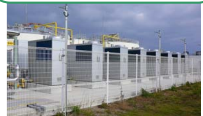
バイオガスを利用した発電機の設置
