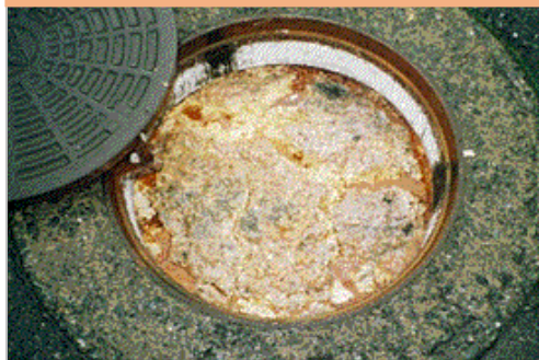
マンホールへ流出した油脂
