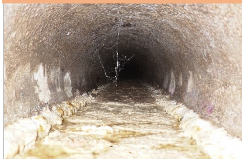
下水道管へ流出した油脂
