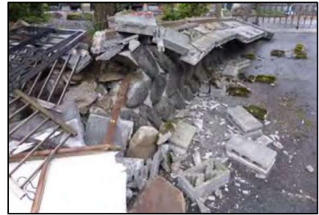
ブロック塀倒壊の様子
