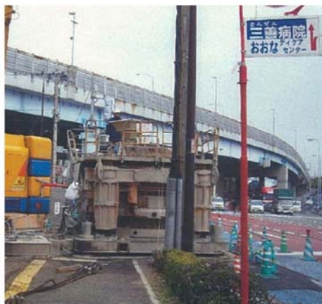
事故後の現場写真
