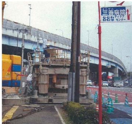
事故後の現場写真
