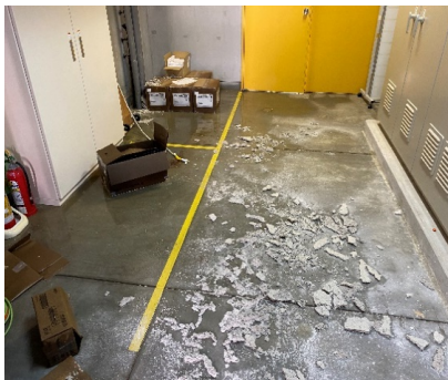
電気室床浸水状況
