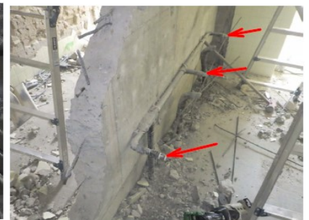
給水管末端(プラグ止め後)
