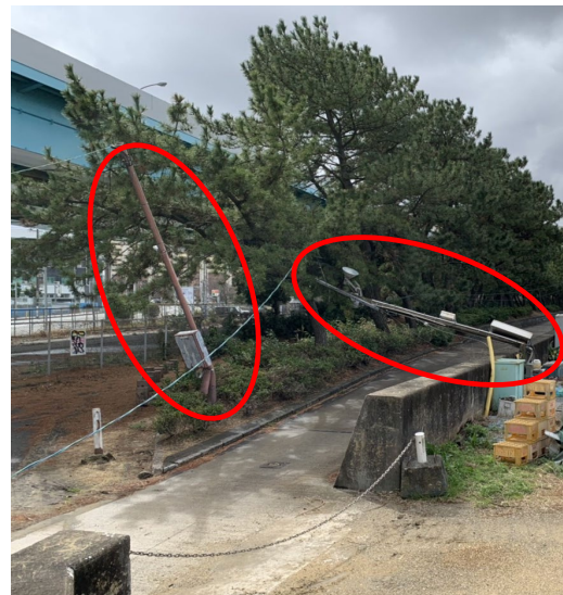
破損箇所(左:引込柱 右:照明灯)
