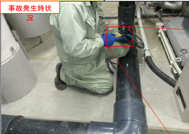
事故発生時状況(拡大)
