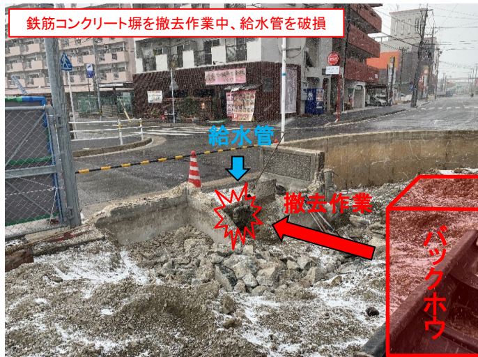
事故発生時の状況
