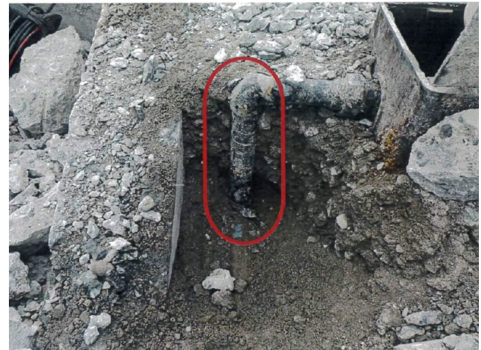
給水管(φ40)の破損箇所
