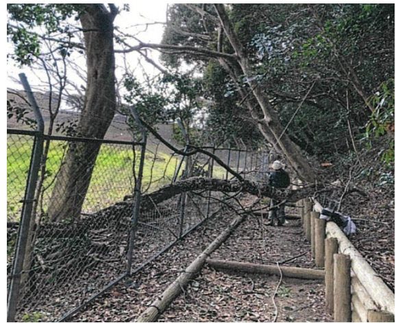
フェンス破損状況
