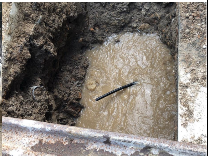
給水管破損状況(近景)
