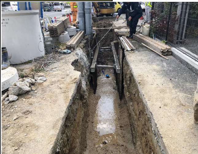
給水管破損状況(遠景)
