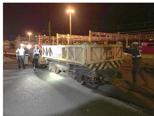
合図が確認できない為、手押し移動している状況
