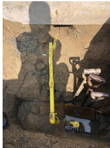
ガス管破損状況
