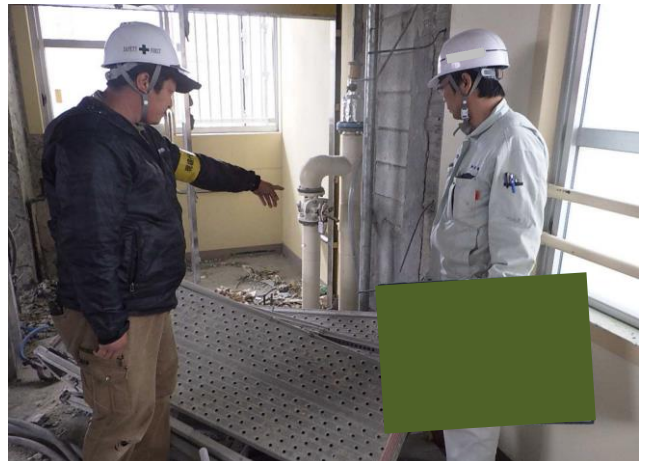
事故状況の確認
